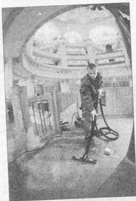
Mit dem Dampfreiniger rückt Norman Köhler von der Firma Top-Gebäudereinigung dem Schmutz in der Frauenkirche zu Leibe.
